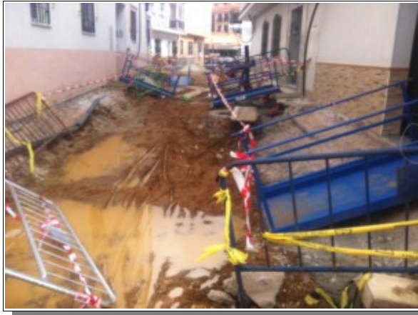
Calle de las Vírgenes donde ha habido varios accidentes a causa de las obras.
